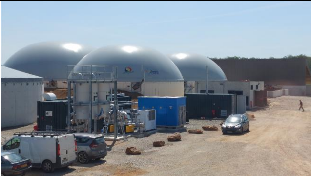
Process Épuration et digesteurs en arrière-plan
