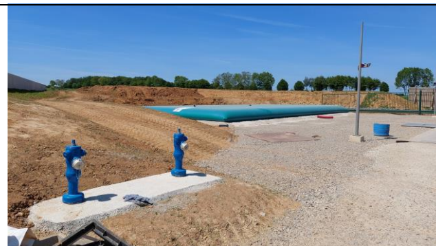
Bâche incendie et poteaux
